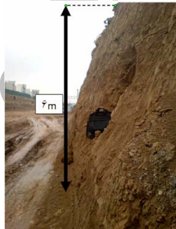
شکل ۸- دیواره ای پایدار با عمق تقریبی ۶ متر و شیب در حدود ۸۰ درجه در ناحیه D 1 (ایمان زاده، ۱۳۸۸).
