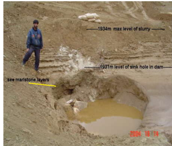
شکل شماره (۶): آبرو چاله ایجاد شده در بخش جنوب غربی
