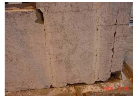
ب) ترک های برشی و ترک های قائم در شناژ
