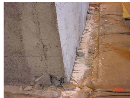
الف) ترک طولی شناژ قائم
