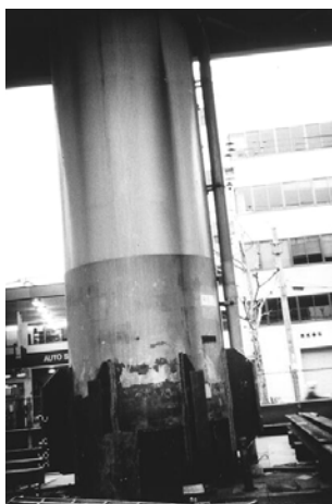
شکل ۱: نمایی از پایه فولادی پل با مقطع دایره‌ای که در زلزله Hyokogen-Nanbu ۱۹۹۵ در ژاپن آسیب دیده و بعد از زلزله با سخت کننده تقویت شده است.
