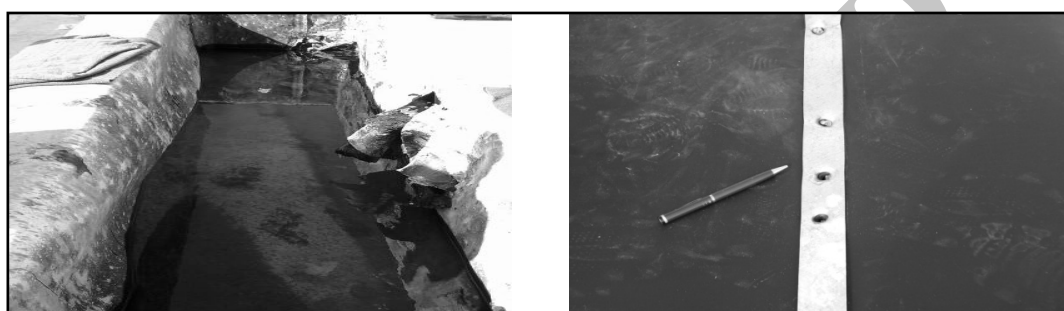
شکل ۳- کیفیت نامناسب اتصال میخ‌های فولادی و جدا شدن پوشش اضافی اجرا شده در ورودی کف استخر.
