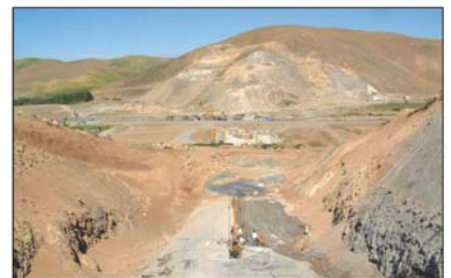
شکل ۳- نمایی از ساختگاه در حال اجرای سد چپرآباد (دید به سمت تکیه گاه راست)
