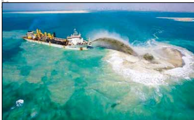
شکل ۴- آشفته‌گی در رسوبات بستر خلیج فارس در اثر استفاده از کشتی‌های لایروب به منظور برداشت مصالح مورد نیاز برای ساخت جزایر مصنوعی.
