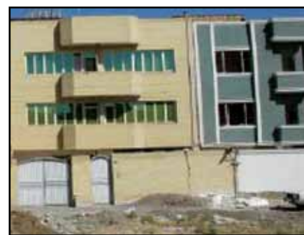
شکل ۶- ترک در دیوار ساختمانی در شهر مشهد به دلیل پدیده فرو نشست (Hosseini et al., 2007).
