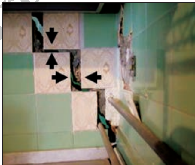
شکل ۱- مؤلفه‌های افقی و عمودی حرکت ناشی از نشست زمین و تخریب ساختمان مسکونی در شهرک طالقانی اشتهارد.
