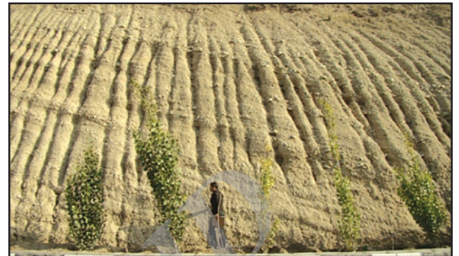
شکل ۲- برش کنار بزرگراه شیخ فضل الله تقاطع بزرگراه رسالت را نشان می‌دهد که لایه‌ها شیبی به سوی جنوب دارند (نگاه به سوی خاور).
