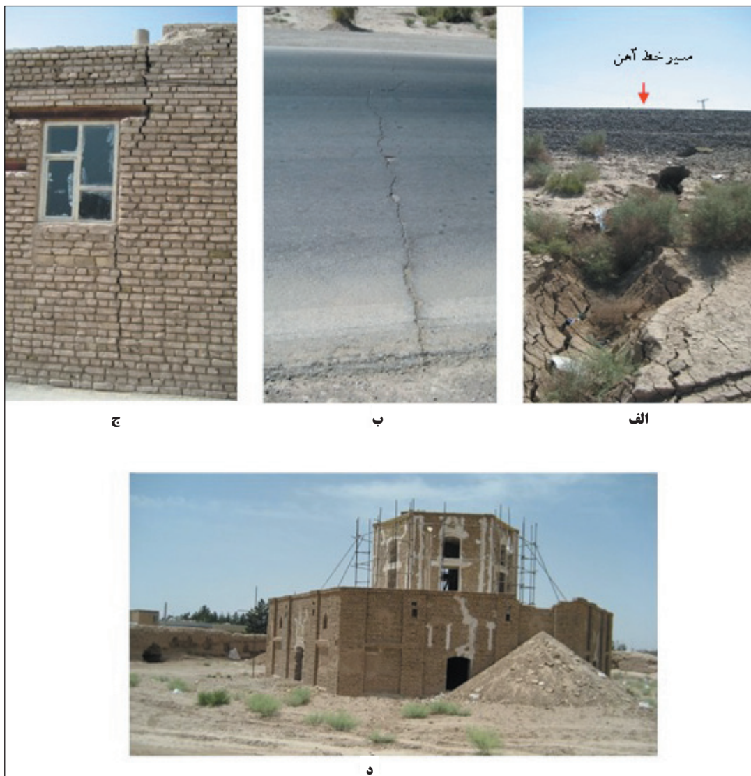
شکل ۹- تأثیر نشست زمین بر روی شریان‌های حیاتی و سازه‌های محدوده مطالعاتی؛ الف) شکاف خوردن زمین در حریم خط آهن؛ ب) شکاف خوردن آسفالت جاده در حریم خط آهن؛ ج) نمونه‌ای از ترک خوردن دیواره جانبی یک منزل مسکونی؛ د) نمایی از بازسازی عمارت تاریخی واقع در روستای اعلاء (برگرفته از مهندسین مشاور پارس پیاب، ۱۳۹۴).
