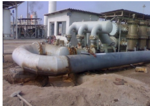
شکل ۲- خوردگی در خط لوله ۱۸ اینچی کارخانه.
