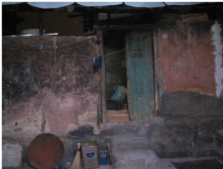
شکل 10: نمایی از یک خانه قدیمی با مصالح نامرغوب ساختمانی در روستای آهار که بر اساس مقیاس MSK در رده A قرار دارد.
