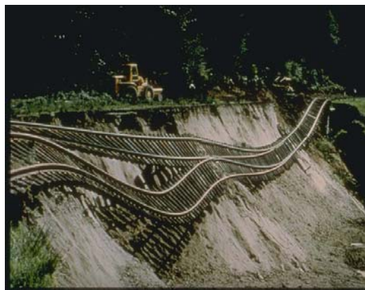
شکل ۹: نمایی از رانش زمین، که توأم با تخریب زیرساخت ها و
