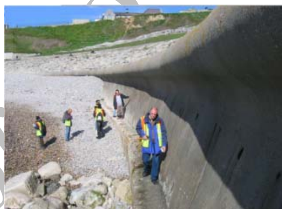
شکل ۱۶: نمایی از ایزولاسیون و زهکشی پناهگاه های ساحلی که با توجه به ریخت زمین در بخش انتهایی مناطق ساحلی احداث شده است
