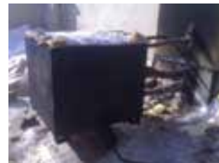
شکل ۴- منبع انبساط باز مکعبی که دچار یخ زدگی شده است
