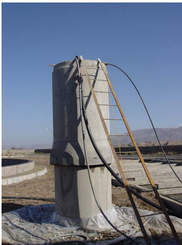
شکل ۲- تصویر راکتور ازناسیون احداث شده در تصفیه‌خانه فاضلاب شهر میانه
