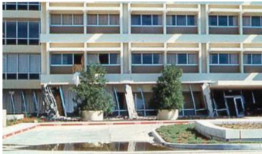
شکل ۱- ایجاد طبقه نرم در بیمارستان الیویو در زلزله ۱۹۷۱ سان فرناندو در اثر حذف دیوارهای برشی طبقه همکف [۷]
