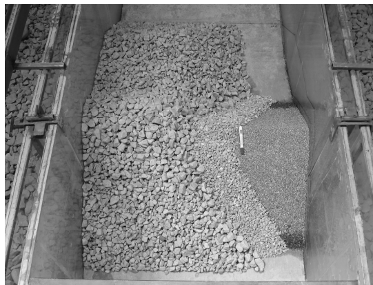
شکل ۴- نمایی از مصالح هسته، فیلتر و آرمور اجرا شده برای ساخت مدل موج شکن سکویی
