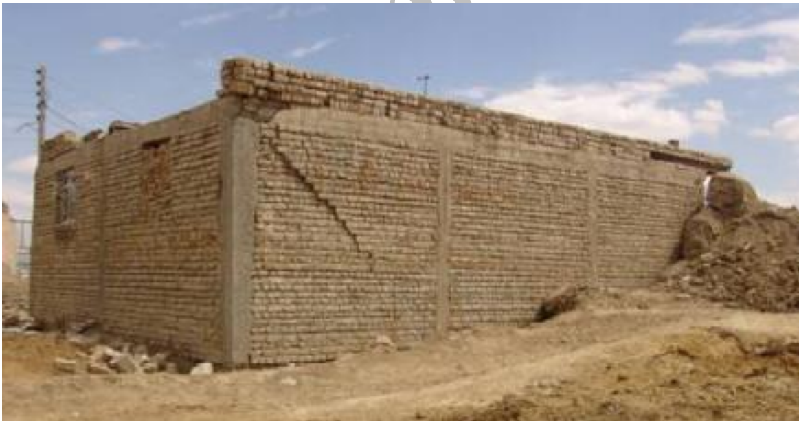
شکل ۱. ترک خوردگی مایل در دیوار یک ساختمان آجری کلافدار (زلزله سیلاخور)
