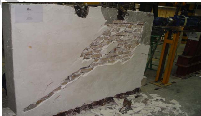
شکل ۱۵. جدا شدن گچ در اثر ترک خوردگی دیوار در آخرین گام بارگذاری
