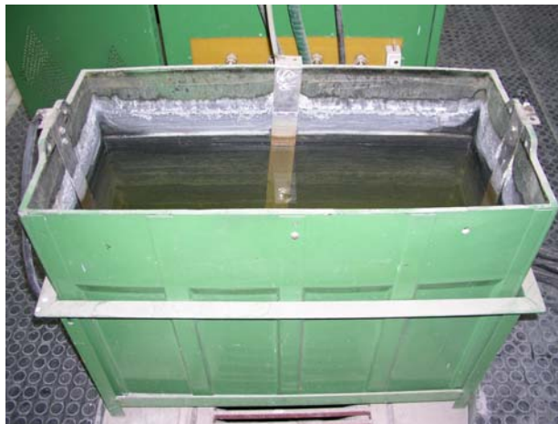
شکل (۳): جعبه مقاومت آبی موجود در مسیر
