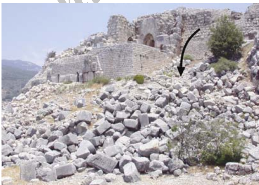
شکل ۶. دیوارهای فروریخته برج دیدبانی شمالی کل ات نیمرد (Kal'at Nimrod)، کرانه خاوری مدیترانه (مارکو، ۲۰۰۸).
