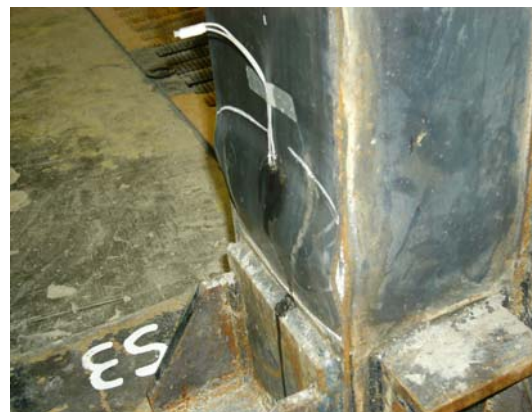
شکل ۲۳ شکست نمونه‌ی S3 در اثر کمناش موضعی جداره‌ی فولادی
