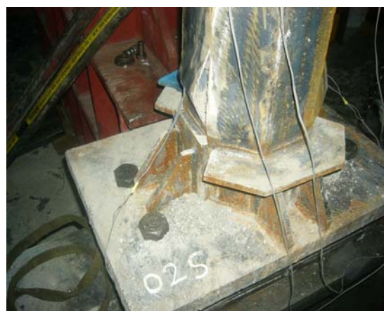
شکل ۳۰ شکست نمونه‌ی O2S در اثر کماتش موضعی جداره‌ی فولادی
