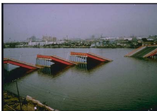
شکل ۱ خرابی پل شووا در زلزله نیگاتا [3]
