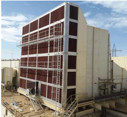
شکل ۲- سیستم مدیا نیروگاه سیکل ترکیبی یزد
