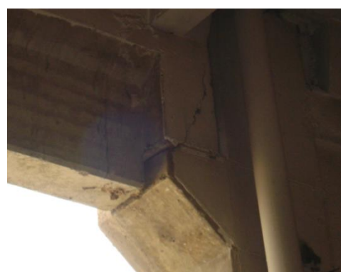
شکل ۳- ترک خوردگی ناشی از تلاش‌های وارده در ناحیه اتصال
