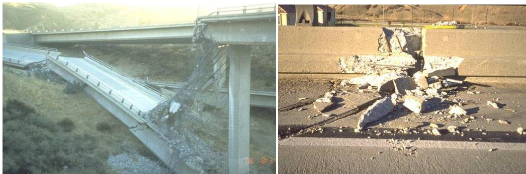
شکل ۱. تخریب پل در زلزله نورتریج (۱۹۹۴) در اثر برخورد
