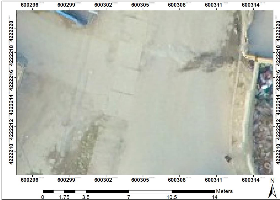
شکل ۵. سطح آسفالت قسمتی از منطقه مورد مطالعه که دارای سه کیفیت متفاوت در همجواری یکدیگر است
