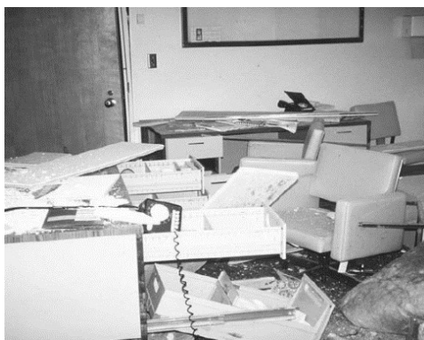
شکل ۲: خسارات وارد به اجزای غیرسازه‌ای ساختمان در زمین لرزه [۱].
