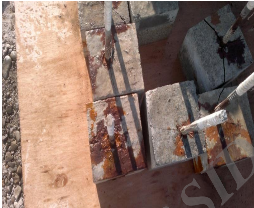
شکل ۱۰: نمونه بتن پس از آزمایش تسریع شده.
