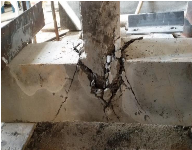
شکل ۸: حالت شکست پیچشی بتن با ۰/۵ درصد الیاف
