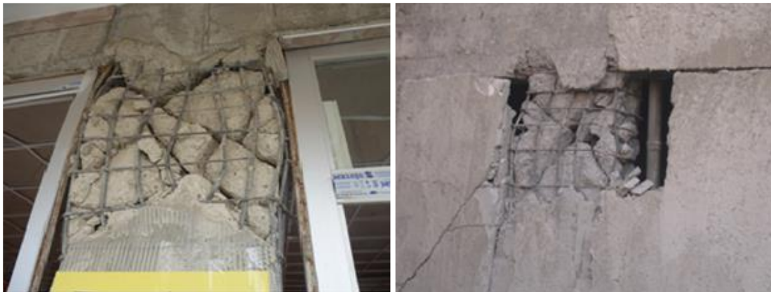
شکل ۱: شکست برشی ستون‌های کوتاه بتن مسلح [۳]
