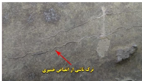
شکل ۷: ترک خوردگی دال
