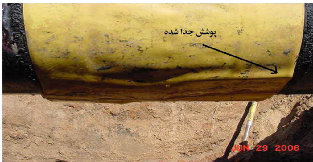
شکل ۱- پوشش جدا شده از سطح خارجی لوله [۱۱].
