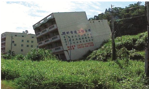
شکل (۳): اندرکنش گسلش و پی در زلزله چی چی (ساختمان بتنی ۴/۵ متر جابه‌جایی را در گسلش معکوس متحمل شده است) [۶].
