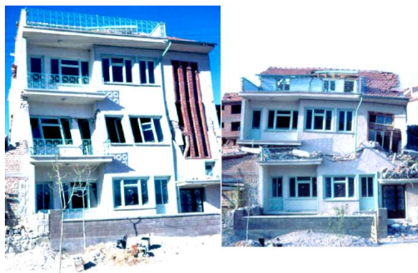
شکل (۱): ساختمان آسیب دیده بعد از لرزش اصلی زلزله گدیز در سال ۱۹۷۰ (عکس سمت چپ)، همان ساختمان پس از یک پس لرزه کوچک تر (عکس سمت راست) [۵].
