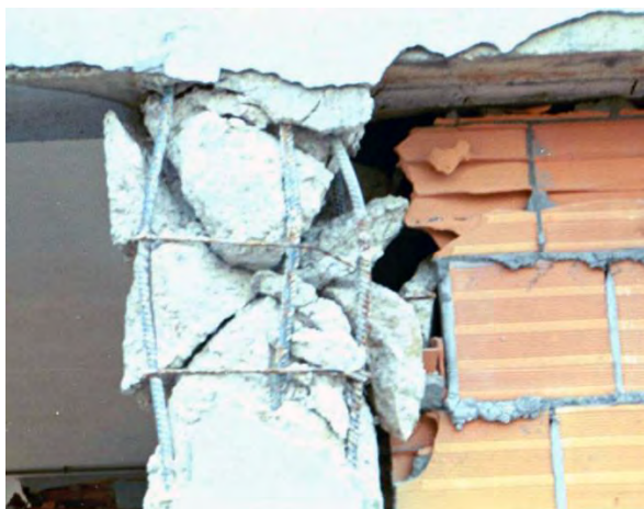
شکل (۱۱): شکست برشی ستون به علت تقابل با دیوار پرکننده آجری (ایتالیا- ۲۰۰۲).
