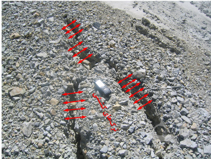
شکل 2: ترک‌های کششی در افق 2550 دیواره غربی
