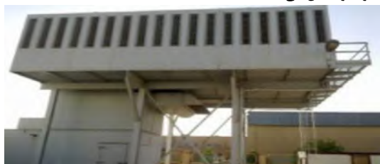
شکل ۳ قسمت سامانه فیلتراسیون در ورودی هوای توربین
