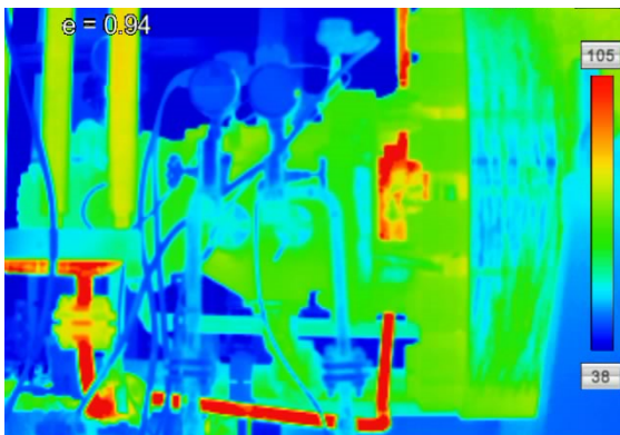
شکل ۱۷. تصویر حرارتی مکانیکال سیل NDE پمپ
