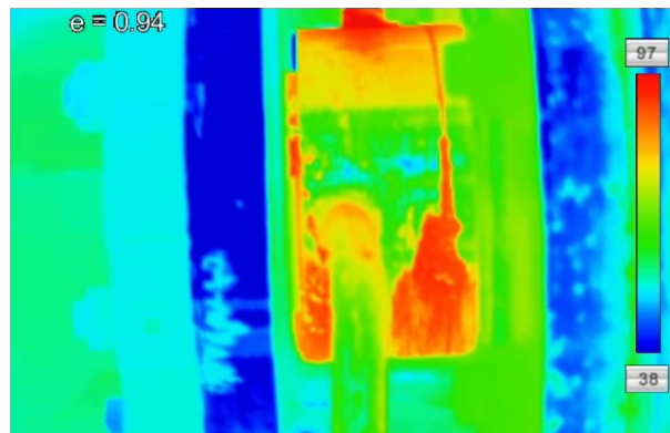
شکل ۱۶. تصویر حرارتی مکانیکال سیل DE پمپ
