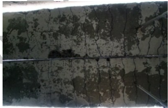
ترک در زیر تیرها
