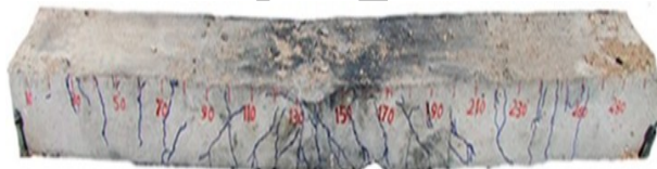
ب) ترک در بدنه جانبی تیر شماره ۲
