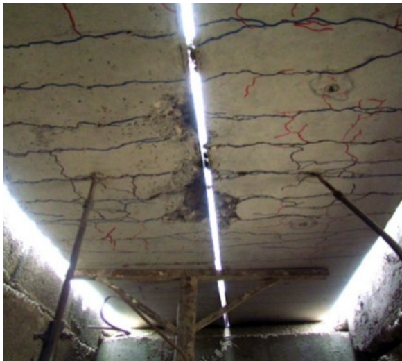
ترک در زیر تیرها
