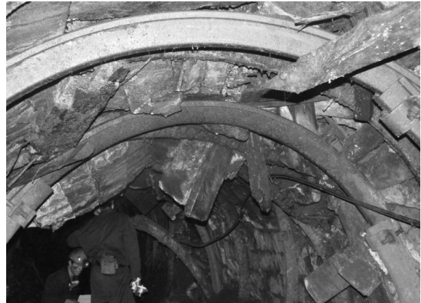
شکل 4: تخریب شدید سیستم نگهداری گالری پست 5 در زیر کارگاه 27 به علت بار مرده ناشی از زون تخریب
