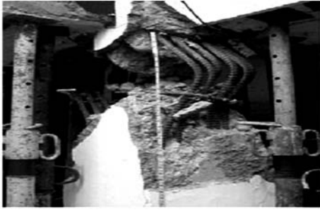
شکل ۱. خرابی شدید در ستون و فاصله زیاد آرماتور عرضی (زلزله ۱۹۹۹ کلمبیا). [۳]
