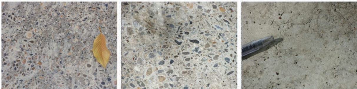
شکل ۳. وضعیت سطح بتن (به ترتیب از راست به چپ)، قبل از آماده‌سازی، پس از زدن ساب و پس از پرکردن حفره‌ها.
