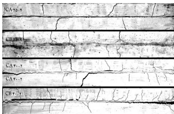
شکل ۱۷. مقایسه‌ی ترک‌های موجود در نمونه‌های بتنی دارای دو لایه از صفحات CFRP در مرحله‌ی ترک‌خوردگی پایدار.
