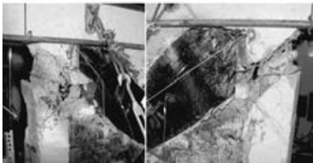
شکل ۱۰. خرد شدن بالای ستون‌ها و خارج شدن مهار از بتن در نمونه‌ی S۱.
