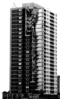
شکل ۱. ساختمان رونان پوینت پس از خرابی. [۱]
