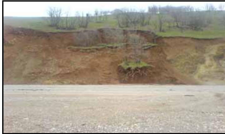
شکل ۹: لغزش توده سست (سارند گوری) در اثر تخریب سطح اتکای دامنه در اثر اعمال مکانیکی احداث جاده
