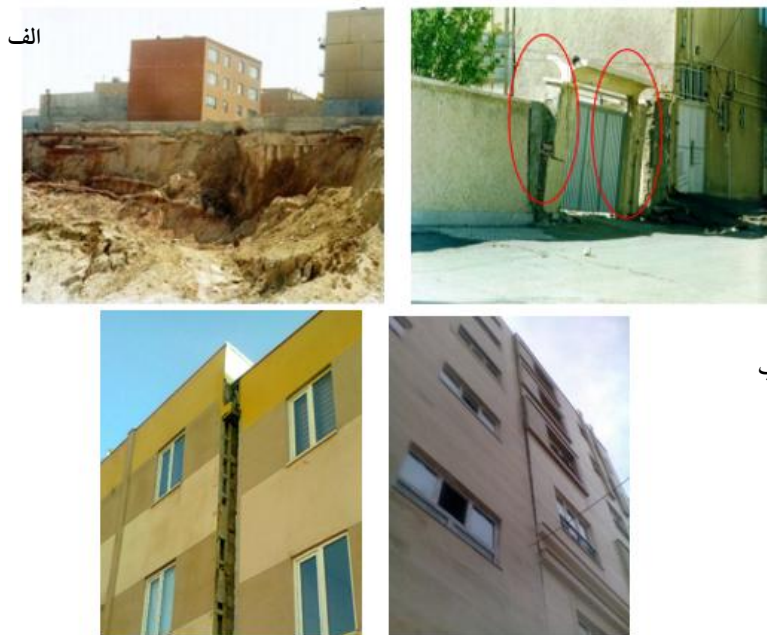
شکل ۳. نمونه‌هایی از مشکلات سازه‌ها در خاک‌های رسی شهر تبریز، الف) نشست و ناپایداری، نگین پارک [۲۴]، ب) انحراف سازه در اثر نشست، باغمیشه و ارم
