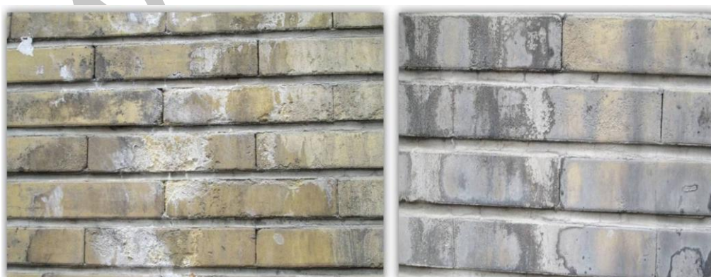
شکل ۷: آثار خوردگی سنگ، تغییر رنگ در اثر تخریب شیمیایی و آلودگی نمای آجری ساختمان، تهران میدان راه آهن، دی ماه ۱۳۹۱.
