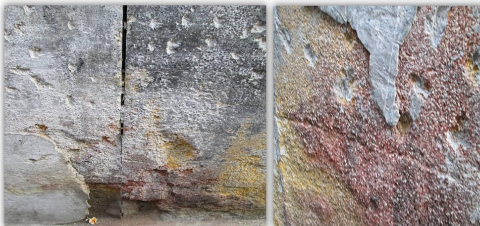
شکل ۸: تخریب شیمیایی شدید، تغییر رنگ و حفره شدن، بازدهی محل اتصال سنگ ها، نمای ساختمان، تهران، بهارستان، کوچه نظامیه، دی ماه ۱۳۹۱.
