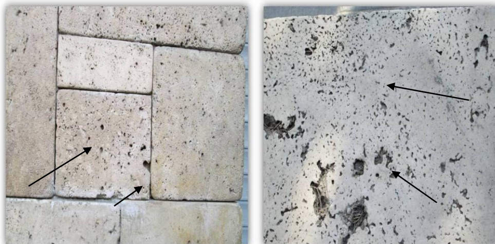
شکل ۹: حفره شدن و تغییر رنگ، بازدهی محل اتصال سنگ ها، نمای ساختمان، تهران، میدان هفتم تیر، خیابان سعدی، دی ماه ۱۳۹۱.
