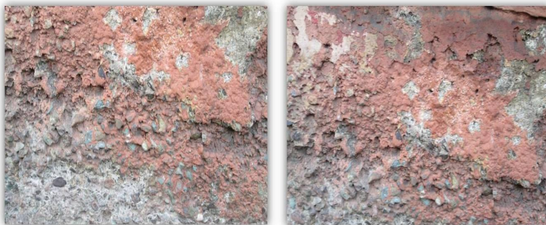
شکل ۱: تجزیه و تخریب شیمیایی شدید، تغییر رنگ، پوسته شدن و خردشدگی دانه ای، نمای ساختمان، تهران، خیابان ابوسعید، دی ماه ۱۳۹۱.
