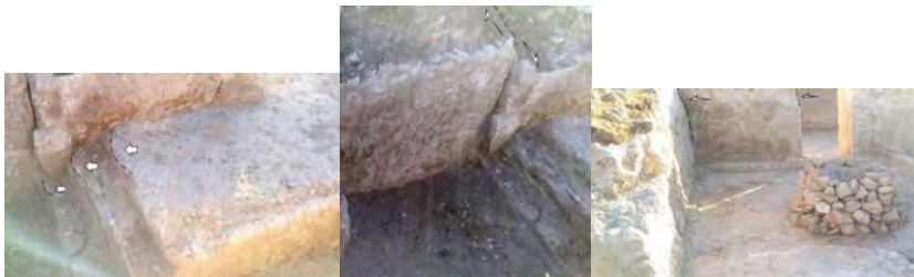
شکل ۳۰. جلوامدگی، شکاف، و جابه‌جایی عرضی در دیواره بنا تاریخی
